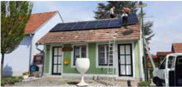
PV-Anlage auf dem Milchhaus in Stettenhof
