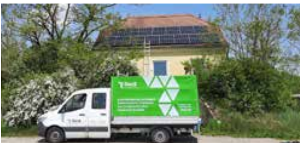
PV-Anlage Hochbehälter Gösing
