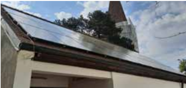
PV-Anlage Aufbahnhalle Fels
