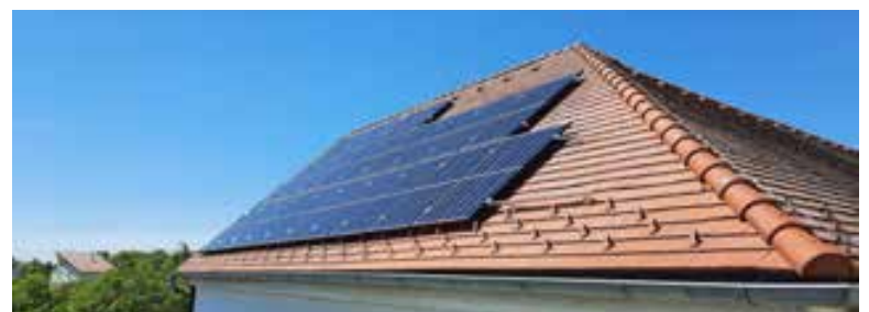
PV-Anlage Dorfzentrum Gösing
