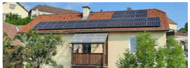
PV-Anlage Milchhaus in Gösing
