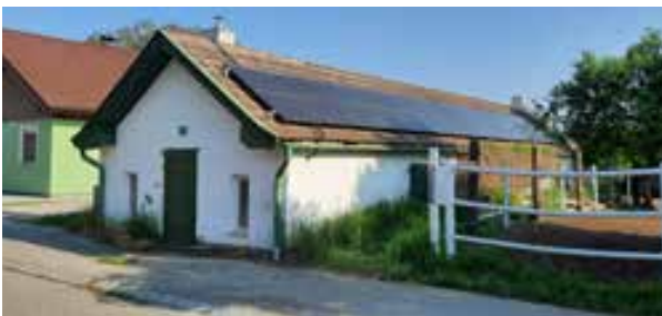
PV-Anlage Treibhaus Fels
