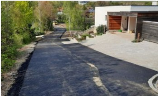
Sanierung vom Birkenweg, Am Berg und südlichen Teil der Kirchengasse in Gösing mit ca. 550 m Länge mit umfangreicher Erweiterung und Sanierung der Glasfaser-, Strom-, Kanal-, Wasser- und Straßenbeleuchtungsinfrastruktur
